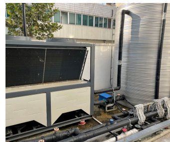
虹房泊寓空气源热泵热水系统
